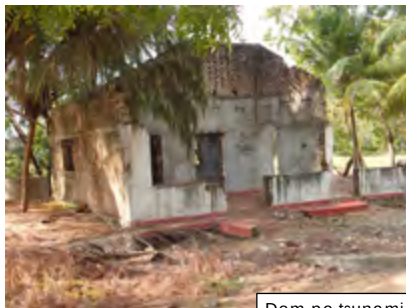
Dom po tsunami
