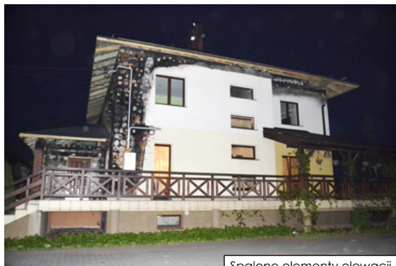
Spalone elementy elewacji
